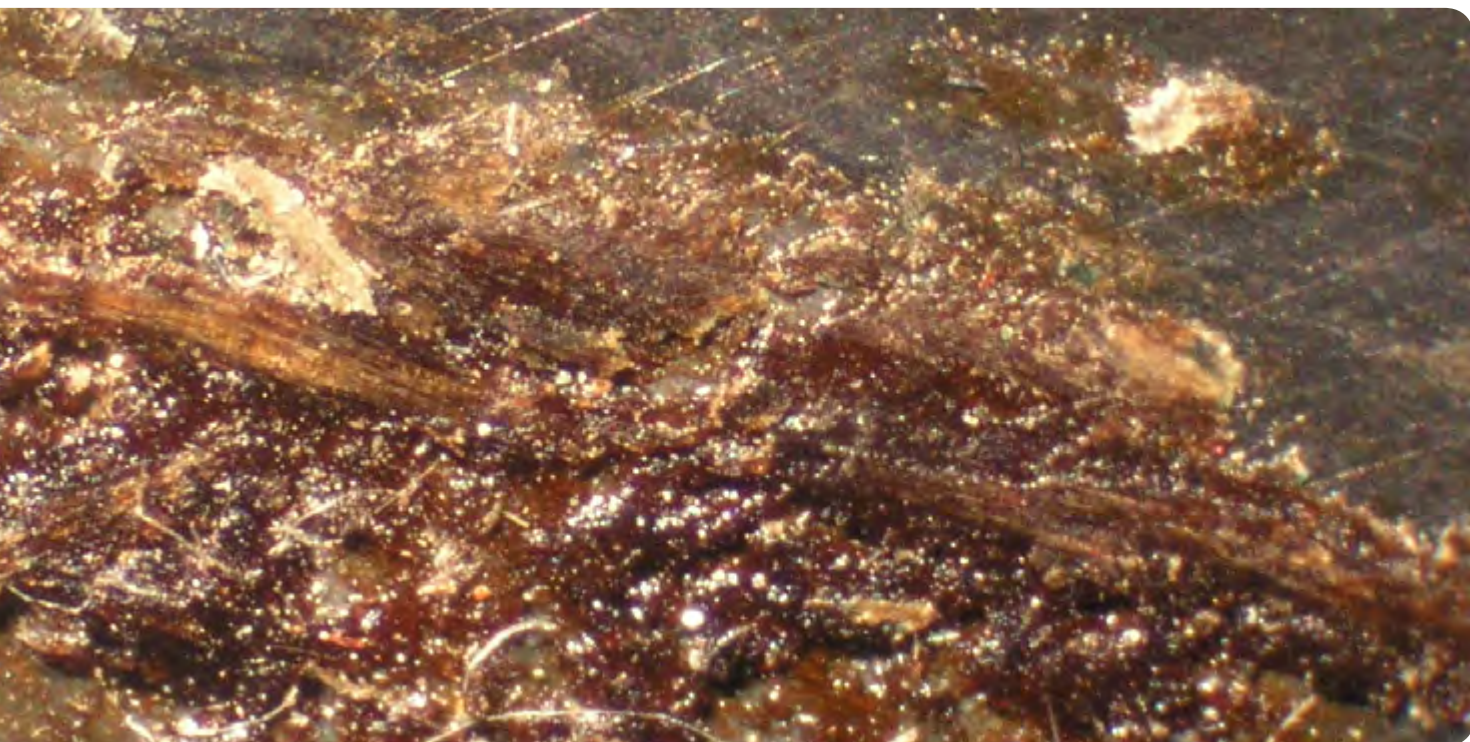
Corrosión y restos de antiguos tratamientos en un acero. Foto Emma García
