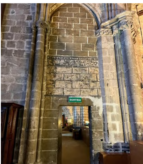
Paramento con distintos rejuntados en la Catedral de Barcelona. Foto Ana Laborde
